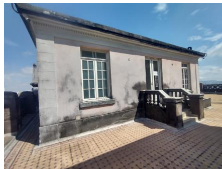
Figura 342 - Biofilme generalizado e lacunas no revestimento da cimalha.
