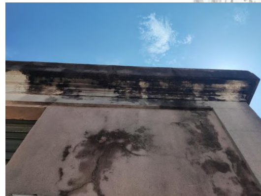
Figura 305 - Biofilme na cimalha e no pano liso da fachada.
