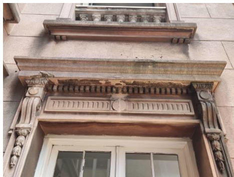
Figura 50 - Desprendimento, sujidade, biofilme e fissura
