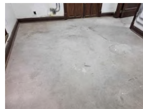
Figura 166 - Carpete da Sala 27-02 em mau estado de conservação.
