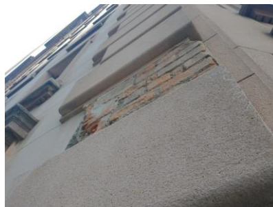
Figura 15 - Lacuna no revestimento com substrato de tijolo exposto.
