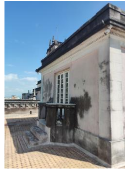
Figura 295 - Platibanda e guarda-corpos com biofilme generalizados; manchas de biofilme nos panos lisos.
