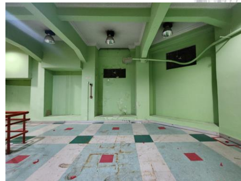
Figura 97 - Nível inferior da Loja 11 com desprendimentos de pintura nas paredes e piso vinílico com sujeira e marcas de oxidação.
