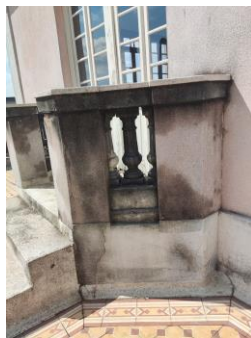
Figura 284 - Fissuração do guarda-corpo nos pontos de conexão; biofilme generalizado.
