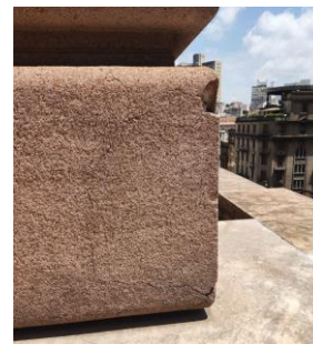
Figura 60 - Desprendimento e fissuras.
