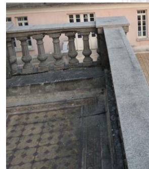
Figura 266 - Sujidade, peças faltantes e biofilme.
