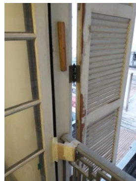
Figura 222 - Veneziana da Sala 27-15 em mau estado de conservação.
