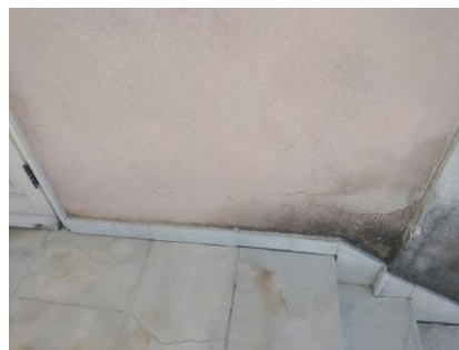
Figura 355 - Fissura no piso em mármore e biofilme no trecho inferior da fachada.
