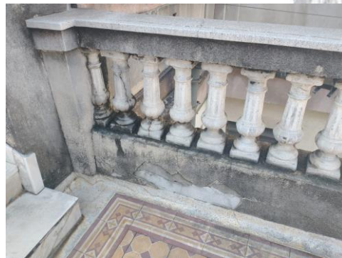
Figura 358 - Lacuna na parte inferior do guarda corpo, ornatos com fissura e biofilme.
