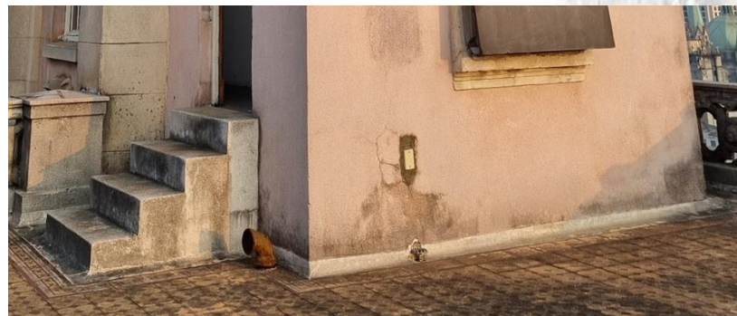
Figura 270 - Sujidade, trincas e destacamento do revestimento.
