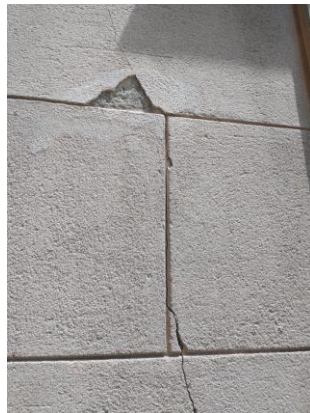
Figura 45 - Desprendimento da argamassa
