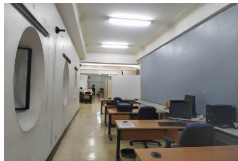
Figura 99 - Mansarda com forro em estuque decorado bicolor em bom estado de conservação e demais revestimentos contemporâneos. Panos lisos das paredes apresentam suidades.
