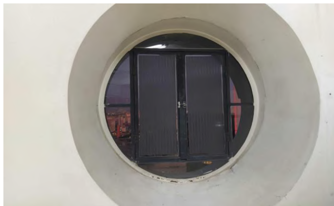
Figura 126 - Lucarna com vidro destoante, problemas de calafetação e oxidação na parte inferior.
