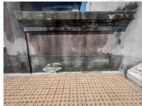
Figura 365 - Biofilme ao longo da fachada e lacuna no revestimento do barrado.
