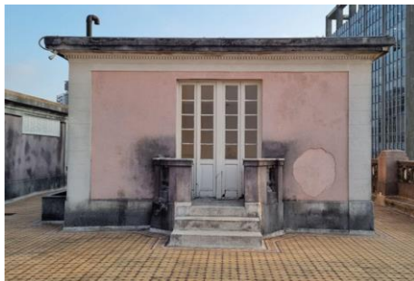
Figura 259 - Sujidade e biofilme no anexo, destacamento do revestimento e rachaduras.
