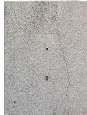
Figura 310 - Elemento espúrio e fissura na fachada.
