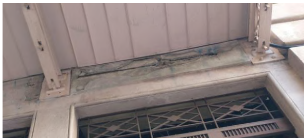
Figura 35 - Fachada da Avenida São João com lacunas na argamassa e exposição da armadura.
