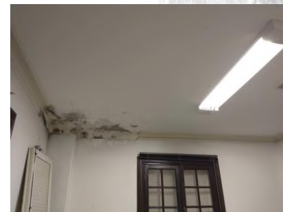
Figura 220 - Detalhe de danos no forro devido à infiltração de água tais como presença de biofilme, desprendimento de pintura e lacunas na moldura.
