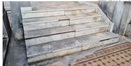
Figura 248 - Rachaduras, desgaste, sujeidade e peças faltantes na escada de mármore da varanda.
