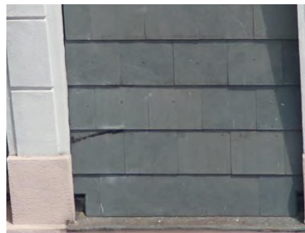
Figura 24 - Telha em ardósia quebrada.
