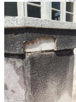
Figura 287 - Lacuna no revestimento do guarda-corpo.
