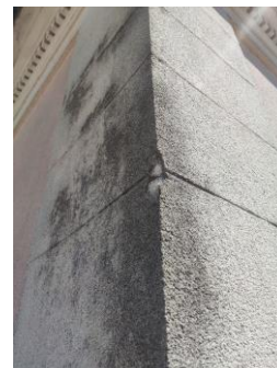
Figura 293 - Quina com lacunas do revestimento e biofilme generalizado.
