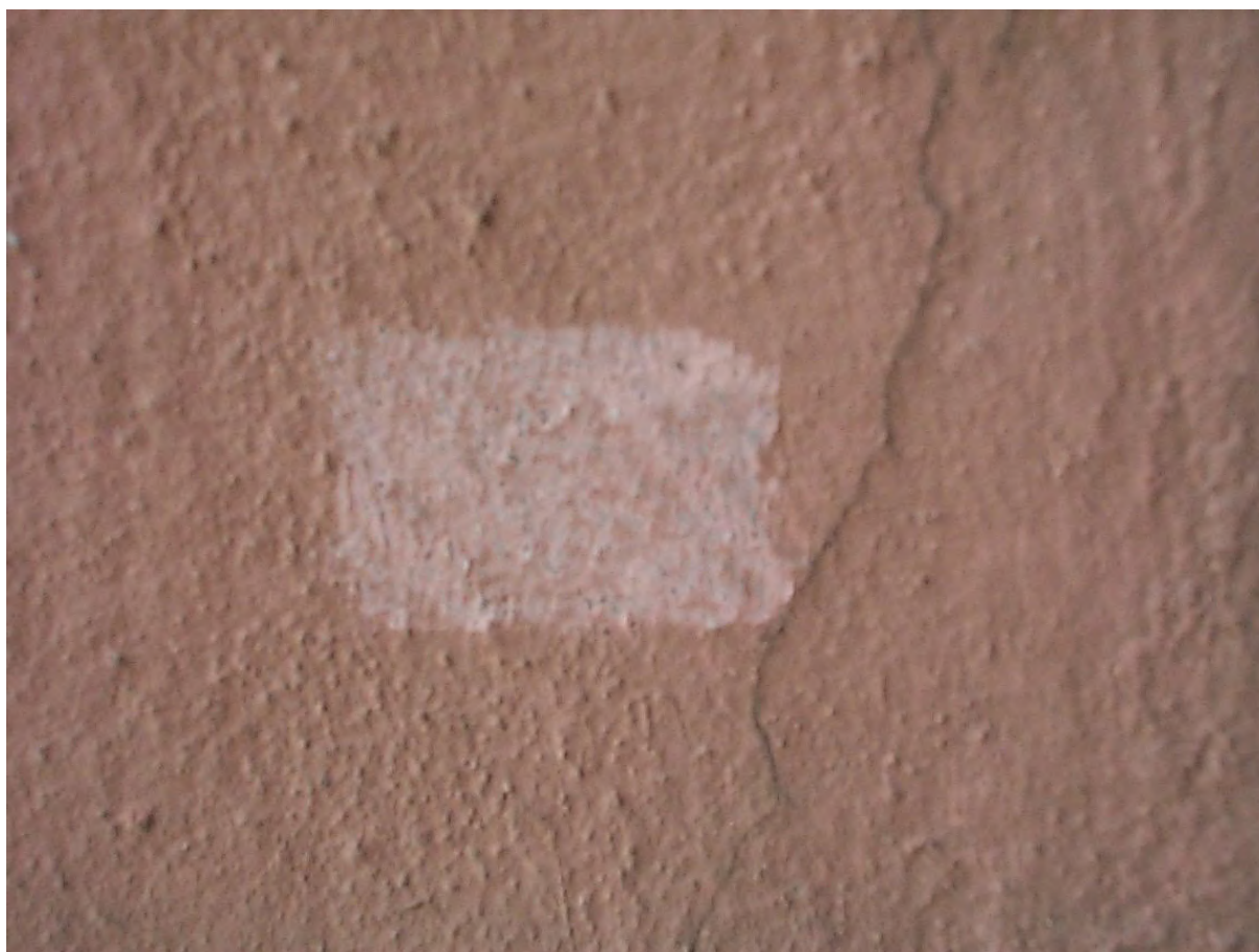
Figura 16 - Cor atual da fachada dos fundos (o trecho mais claro corresponde à área limpa). Fonte: Acervo Estúdio Sarasá.
