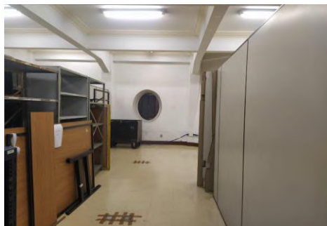
Figura 120 - Piso vinílico com reparos e pano liso com sujidades.
