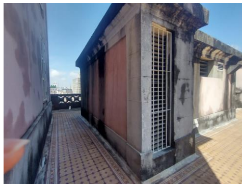
Figura 352 - Biofilme nos panos lisos por escoamento de água; biofilme generalizado nas cimalhas e barrados.
