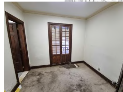
Figura 186 - Vista geral da Sala 27-06 com carpete em mau estado.
