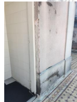
Figura 335 - Lacuna do revestimento da quina do requadro. Ponto de retenção de umidade por fissuração do barrado.
