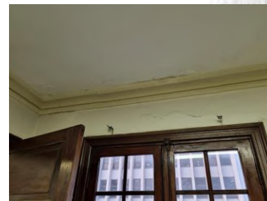
Figura 179 - Marcas de infiltração no forro com formação de biofilme e desprendimento de pintura. Trinca sobre a janela. na Sala 27-04.
