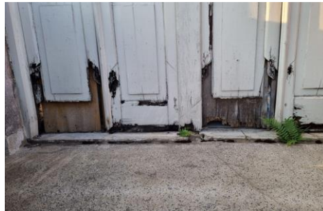
Figura 255 - Esquadria de madeira com perda de peças, vegetação parasitária, e rachadura no piso.
