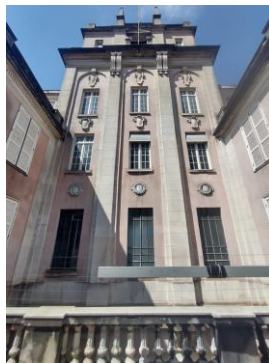
Figura 357 - Biofilme em trechos do ornato, nas cimalhas e ao longo da fachada.
