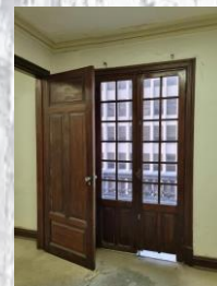
Figura 180 - Porta/janela da Sala 27-04 com perda de peça no trecho inferior. Porta interna em bom estado.
