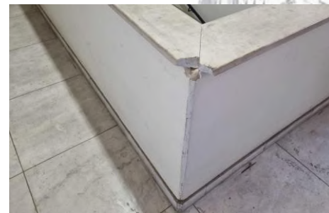
Figura 209 - Detalhe da aresta do parapeito de mármore quebrada.
