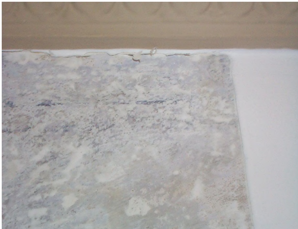
Figura 10 – Prospeção A6 com detalhe de remanescente de faixas e filetes em estado mau estado de conservação. Fonte: Acervo Estúdio Sarasá.
