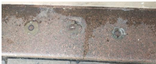
Figura 5 - Desgastes no degrau de entrada e enxertos mal executados, indicado em verde na elevação.
