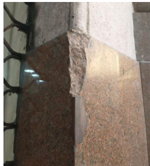
Figura 29 - Embasamento da edificação com trechos lascados e enxertos destoantes do conjunto. Térreo.
