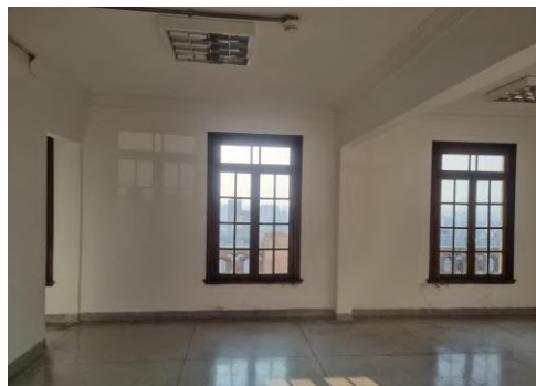
Figura 157 - Forros de gesso com trecho de moldura faltante e piso em granilite em bom estado na Sala 26-09.
