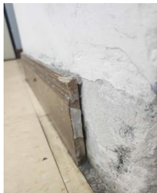
Figura 127 - Rodapé de madeira com partes faltantes.
