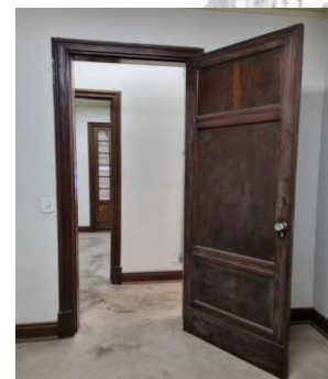
Figura 173 - Pisos revestidos com carpete em mau estado. Porta apresentando envelhecimento da camada protetiva.
