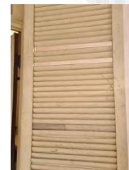
Figura 155 – Veneziana de madeira com aletas faltantes na Sala 26-07.
