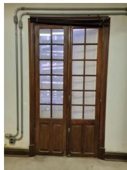
Figura 168 - Folha interna da porta da Sala 27-02 em bom estado, registrando danos no trecho inferior.
