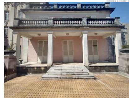
Figura 354 - Biofilme em toda a fachada argamassada e no espelho das escadas. Elemento faltante na esquadria em madeira.
