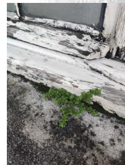
Figura 338 - Vegetação parasitária no requadro; biofilme, ressecamento de madeira e desprendimento de pintura generalizados.
