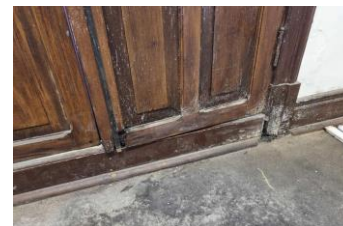
Figura 185 - Sujidade em esquadrias e rodapés e manchas de umidade.
