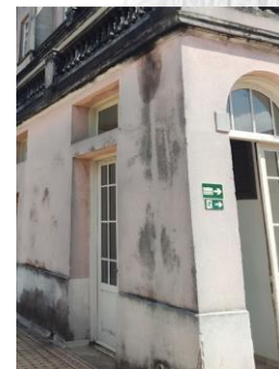
Figura 325 - Biofilme na cimalha e barrado; ponto de umidade por infiltração; concentrações esparsas de biofilme nos panos lisos.
