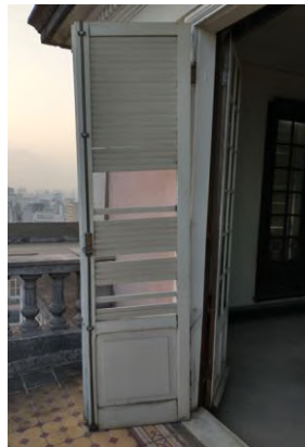
Figura 265 - Sujidade e biofilme no guarda-corpos. Veneziana com peças faltantes e ladrilhos hidráulicos com peças escurecidas
