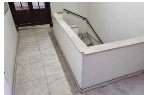
Figura 208 - Piso cerâmico da Circulação 27-12. Aresta do parapeito de mármore quebrada.
