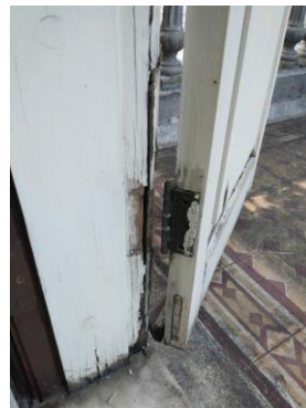
Figura 215 - Detalhe do estado de conservação da porta.
