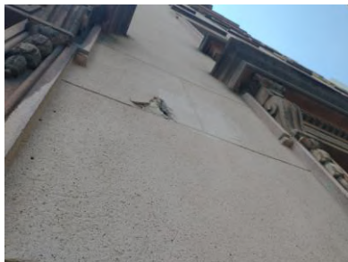
Figura 12 - Trecho da fachada com lacuna no revestimento e biofilme nos ornatos.
