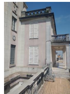
Figura 369 - Biofilme nos ornatos do guarda corpo, peças faltantes na escada em mármore e desgaste no rejunte do ladrilho hidráulico.
