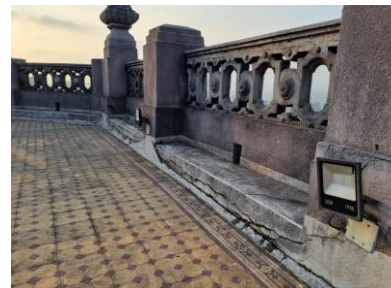
Figura 237 - Rachadura na base do guarda-corpos e ladrilhos hidráulicos com peças desgastadas e escurecidas.
