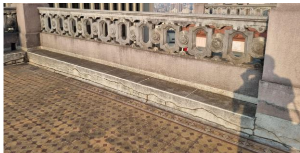
Figura 244 - Rachadura contínua no revestimento em fulget e ladrilhos hidráulicos desgastados e escurecidos.
