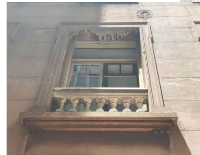
Figura 59 - Desprendimento com exposição da estrutura, fissuras, enxertos, biofilme e infiltração.
