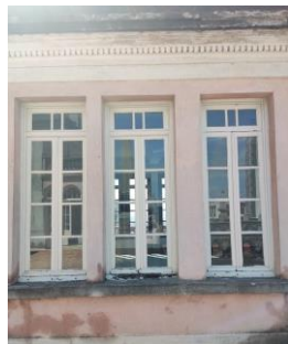
Figura 276 - Decomposição das pingadeiras e biofilme no peitoril e cimalha.
