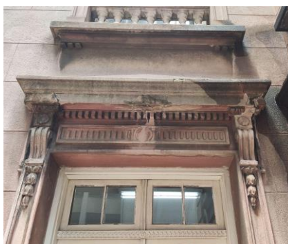
Figura 51 - Sujidade, biofilme e fissura.
