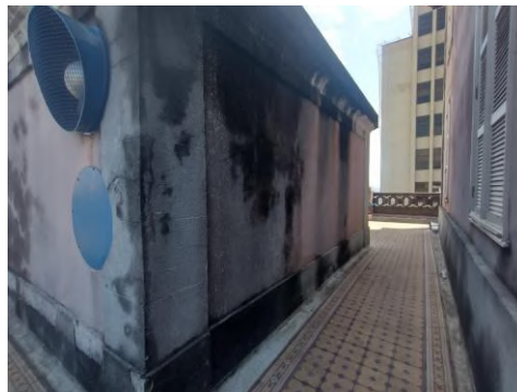
Figura 351 - Biofilme generalizado na cimalha e barrado.
