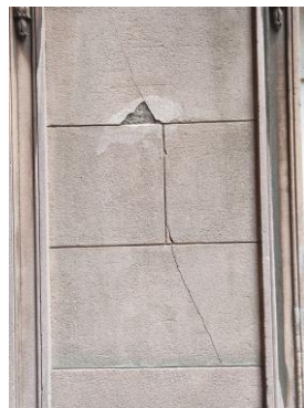
Figura 57 - Desprendimento, fissuras e enxertos.
