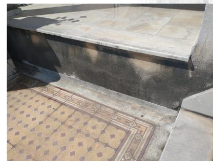
Figura 356 - Biofilme na fachada, no ladrilho hidráulico e no piso em mármore.
