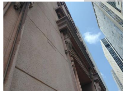
Figura 16 - Recomposição de ornato em processo de desprendimento com fissura nas extremidades.
