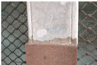
Figura 34 - Pichação e desgaste na fachada no nível do térreo.
