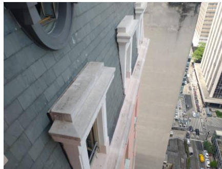
Figura 23 - Sujidade nas telhas em ardósia e formação de biofilme na moldura das janelas.
