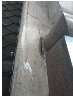
Figura 30 - Fissuras no revestimento próximo à entrada da Avenida São João, número 37.
