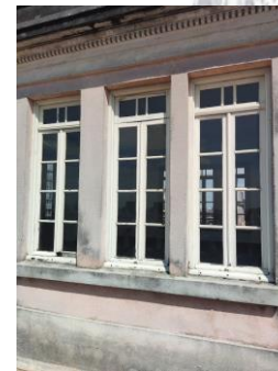
Figura 290 - Biofilme generalizado na cimalha, barrado e peitoril; apodrecimento da madeira nas porções inferiores.
