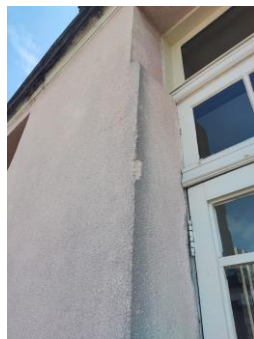
Figura 322 - Quina com lacunas do revestimento e biofilme.
