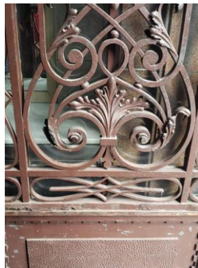
Figura 6 - Porta de acesso da Rua Líbero Badaró com pontos de oxidação, indicado em amarelo.
