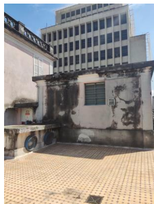
Figura 306 - Biofilme na fachada e no embasamento.
