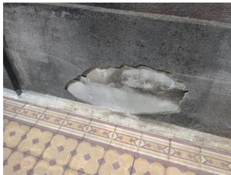
Figura 364 - Lacuna no revestimento do barrado.
