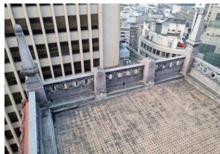
Figura 239 - Ladrilhos hidráulicos com peças desgastadas e escurecidas.
