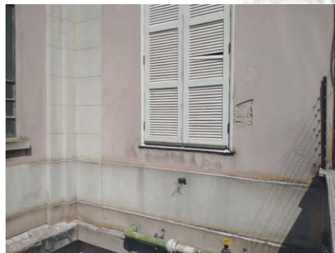
Figura 360 - Peça faltante na esquadria em madeira, lacuna no revestimento, elemento espúrio e biofilme na fachada.
