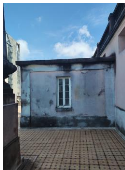
Figura 326 - Vista com biofilme generalizado, fissuração e esquadria com madeira deteriorada.
