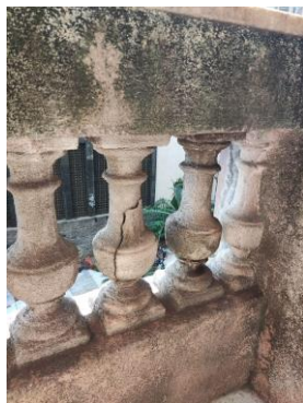
Figura 55 - Fissura e sujidade.
