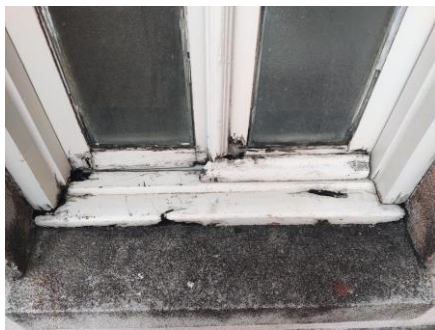
Figura 329 - Madeira do peitoril deteriorada, pingadeira faltante e biofilme no peitoril.
