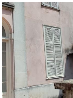
Figura 316 - Parede com fissuração e presença de biofilme.
