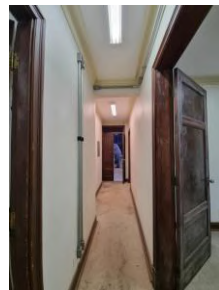
Figura 195 - Vista geral do Corredor 27-09 com pintura em bom estado e carpete deteriorado.
