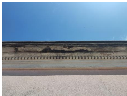
Figura 292 - Biofilme na cimalha.
