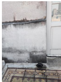
Figura 339 - Barrado com fissuras e biofilme e ladrilhos hidráulicos com peças desgastadas e escurecidas.
