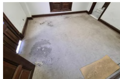
Figura 178 - Carpete da Sala 27-04 em mau estado de conservação.
