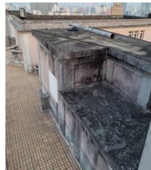
Figura 253 - Sujidade e biofilme intenso na fachada e na cobertura da escada de emergência.
