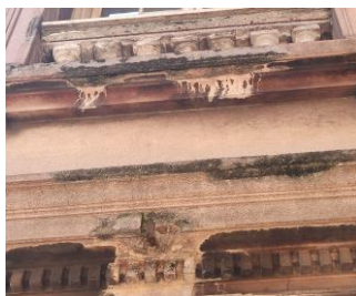
Figura 56 - Desprendimento, sujidade e biofilme.
