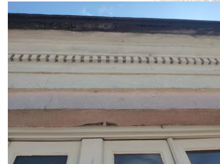
Figura 302 - Biofilme generalizado na cimalha e lacunas de revestimento no requadro.
