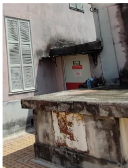
Figura 314 - Presença de biofilme, lacunas no revestimento argamassado e oxidação de elemento metálico.
