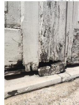
Figura 283 - Desplacamento de pintura, ressecamento e apodrecimento da madeira.
