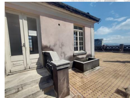
Figura 343 - Porta de entrada com parte inferior apresentando madeira deteriorada, degraus de granilite com fissuração.
