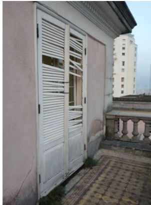
Figura 264 - Sujidade, rachaduras e destacamento do revestimento, vegetação parasitária e peças faltantes.
