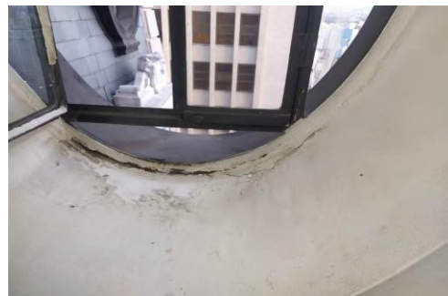
Figura 108 - Lucarnas com massa de vidro faltante e lacuna na calafetação.
