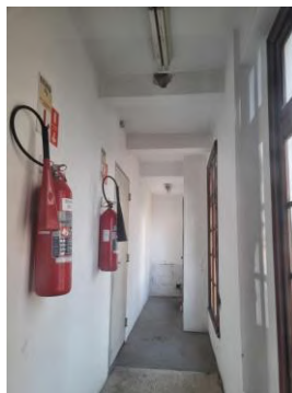
Figura 232 - Vista geral do Corredor 28-04 com piso cimentício e paredes com sujidade.
