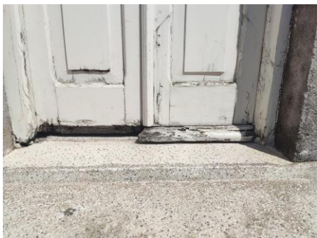
Figura 291 - Elementos de madeira faltantes; apodrecimento e ressecamento generalizados nas porções inferiores; deslocamento de pintura generalizado.
