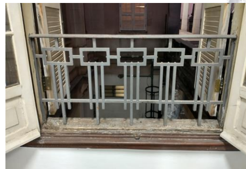
Figura 142 - Gradil metálico preservado com pontos de oxidação.
