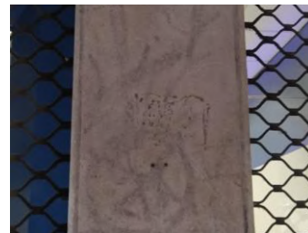
Figura 82- Pichação na fachada no nível do térreo próximo à entrada da Rua São Bento, número 397.
