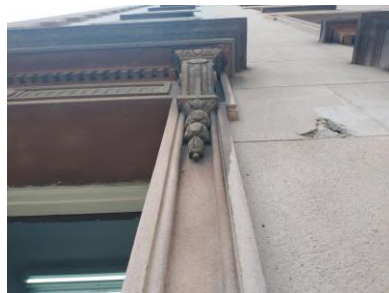
Figura 14 - Trecho da fachada com lacuna no revestimento e biofilme e desgaste no revestimento dos ornatos.
