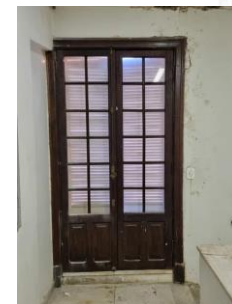
Figura 210 - Danos causados por infiltração na Circulação 27-12.
