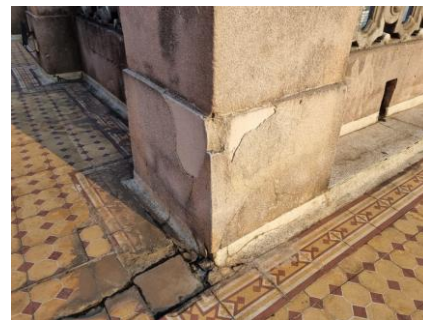
Figura 243 - Rachadura, peças de ladrilho faltantes e destacamento do pilarete.
