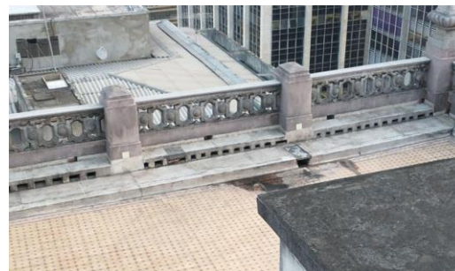
Figura 240 - Ladrilhos hidráulicos desgastados e escurecidos, desnível do piso e acúmulo de água.
