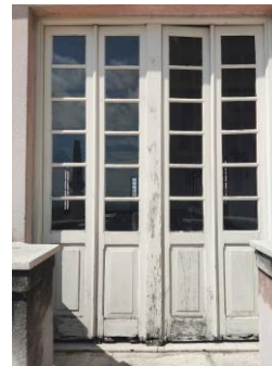
Figura 282 - Deterioração da madeira na porção inferior.
