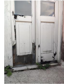
Figura 297 - Elementos de madeira faltantes; vegetação parasitária na soleira.
