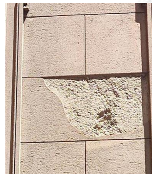
Figura 42 - Desprendimento da argamassa.
