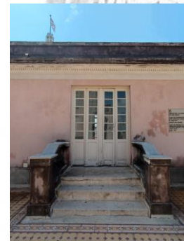
Figura 274 - Biofilme nos guarda-corpos e cimalha.
