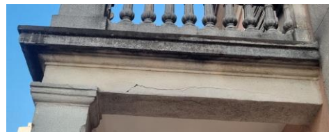
Figura 261 - Rachadura no revestimento da viga do terraço.
