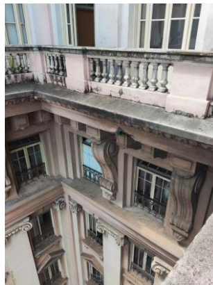
Figura 69 - Biofilme no beiral e nos ornatos, excremento de aves no peitoril das janelas.
