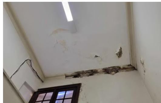
Figura 205 - Detalhe dos danos no forro causados por infiltração.
