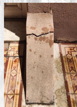
Figura 43 - Fissura e biofilme.
