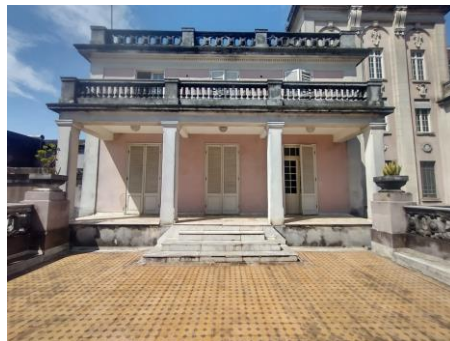
Figura 361 - Biofilme no espelho da escada em mármore, na cimalha e nos ornatos do guarda-corpo.
