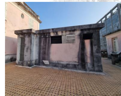
Figura 257 - Formação de biofilme na casa de máquinas.
