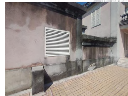
Figura 367 - Lacuna no revestimento, biofilme na cimbalha e ao longo do pano liso da fachada.
