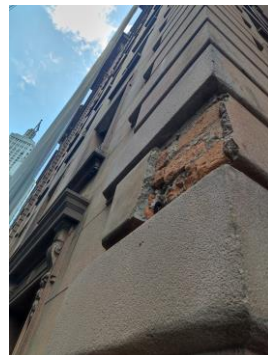
Figura 41 - Lacuna na argamassa com exposição da estrutura em alvenaria.
