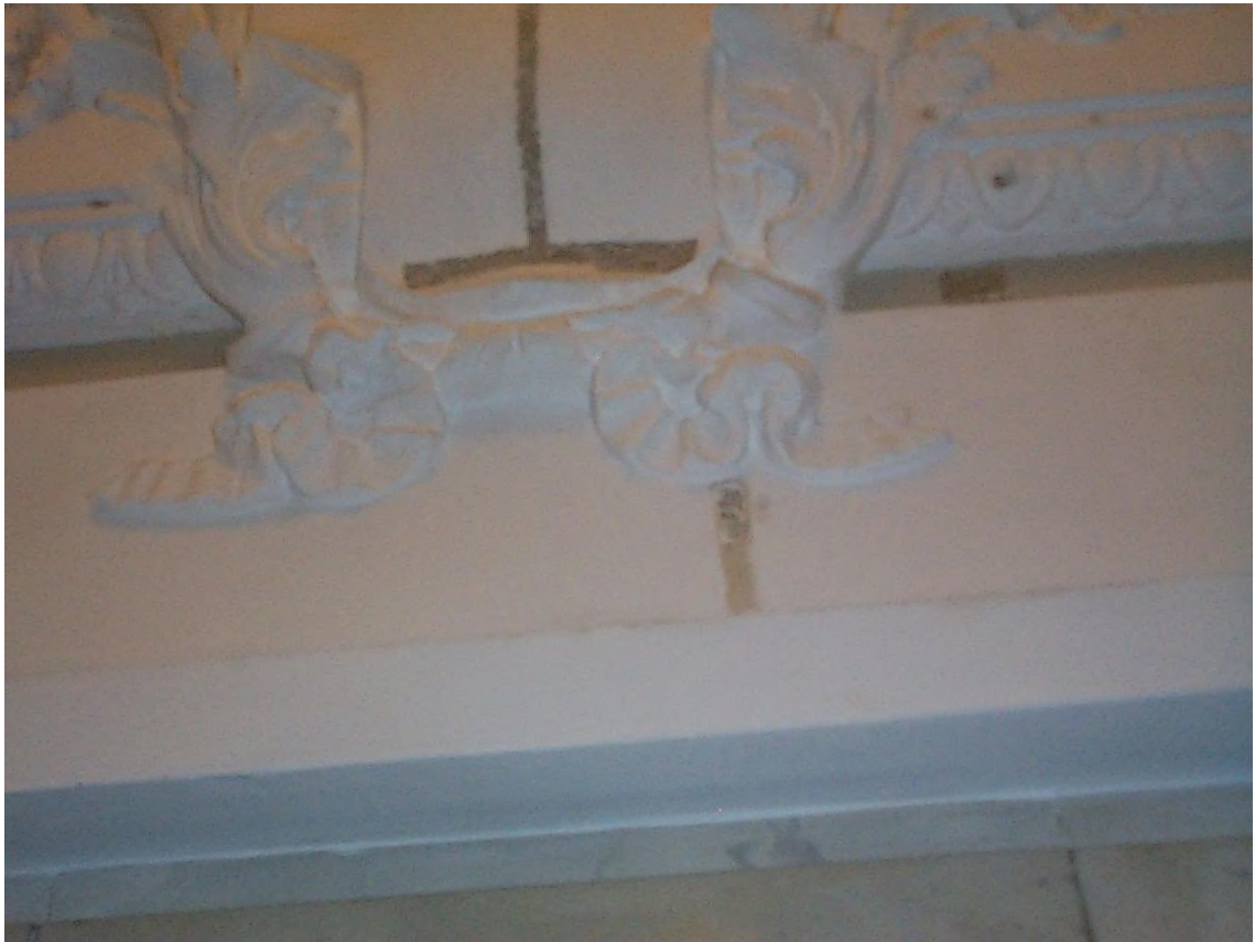
Figura 20 – Prospecção no medalhão acusando que esse elemento assim como grande parte do revestimento do prédio foi raspado e ou substituídos. Fonte: Acervo Estúdio Sarasá.
