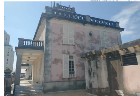
Figura 349 - Biofilme generalizado nos guarda-corpos e cimbalhas. Pontos de umidade esparsos nos painéis lisos.
