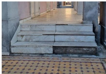
Figura 250 - Rachaduras e ausência de peças da escada em mármore.
