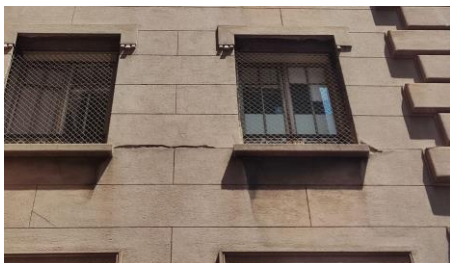
Figura 54 - Biofilme, desprendimento, fissuras e enxertos destoantes.
