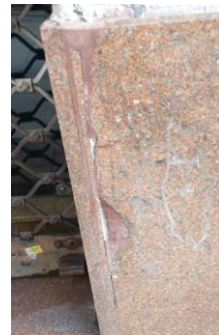
Figura 31 - Embasamento da edificação com lacunas e enxertos destoantes do conjunto.
