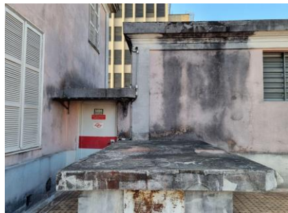
Figura 260 - Sujidade e biofilme, rachadura, destacamento do revestimento.
