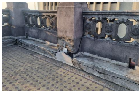
Figura 246 - Rachaduras no fulget e piso de ladrilho, e destacamento do revestimento do pilarete. Presença de biofilme no guarda-corpo.
