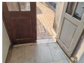
Figura 131 - Esquadrias de madeira, com ressecamento pela ação do tempo na porção inferior.
