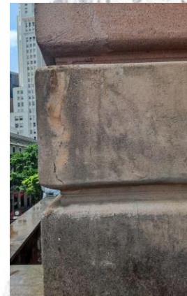
Figura 48 - Fissura e biofilme
