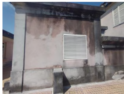
Figura 368 - Lacuna no revestimento, biofilme na cimbalha e ao longo do pano liso da fachada.
