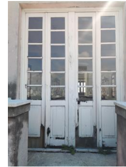
Figura 296 - Apodrecimento da madeira nas porções inferiores; deslocamento de pintura generalizado.
