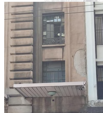
Figura 11 - Trecho da fachada com deslocamento de argamassa.
