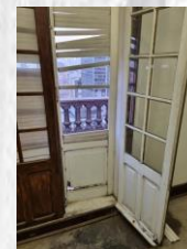
Figura 187 - Folhas externas e face externa da folha interna com danos decorrentes da exposição às intempéries e à falta de manutenção, apresentando ressecamento e perda de trechos da madeira.
