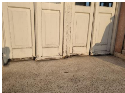
Figura 254 - Esquadria com madeira ressecada e peças faltantes.
