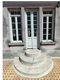
Figura 289 - Fissuração da granilite dos degraus; biofilme generalizado nos painéis lisos.
