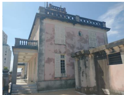
Figura 353 - Concentração de biofilme no guarda corpo e ao longo da fachada.
