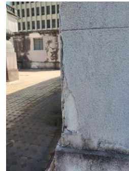
Figura 301 - Lacuna de revestimento argamassado; piso com sujeira impregnada e biofilme rente à edificação.
