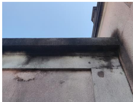
Figura 330 - Concentração de biofilme na cimalha.
