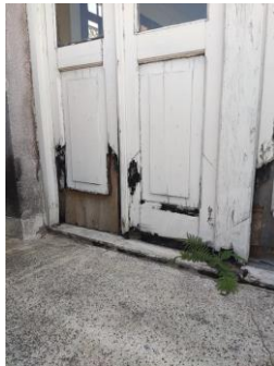
Figura 298 - Elementos de madeira faltantes; vegetação parasitária na soleira.
