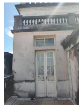
Figura 340 - Biofilme generalizado, desprendimento de pintura e fissuração.
