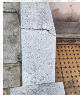
Figura 280 - Fissuração da granilite de revestimento.
