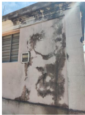
Figura 307 - Biofilme e fissuras na fachada.
