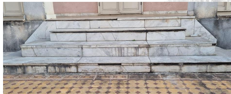
Figura 251 - Rachaduras e ausência de peças do acabamento frontal dos degraus da escada em mármore, e ladrilhos hidráulicos escurecidas.
