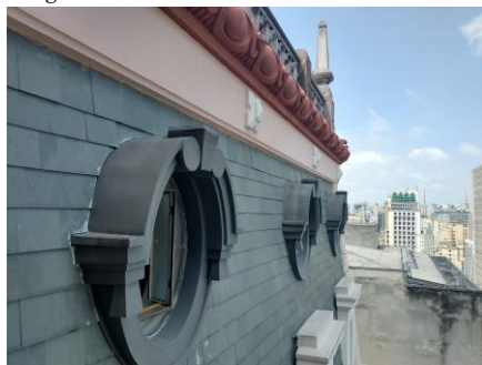
Figura 22 - Telhas em ardósia com pontos de sujidade e caixilho da janela com pontos de oxidação.
