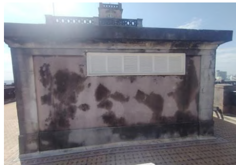
Figura 348 - Pontos esparsos de biofilme nos painéis lisos; cobertura completa de biofilme no barrado e cimbalha.
