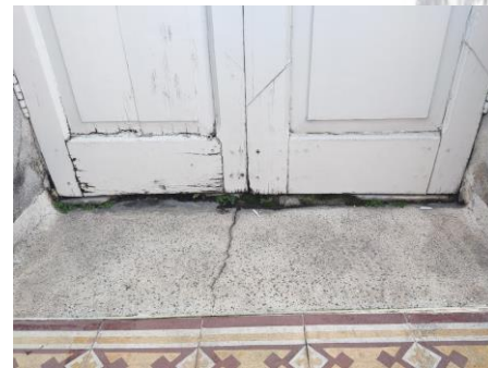
Figura 320 - Fissura da granilite e vegetação parasitária na soleira; elementos de madeira apodrecidos.
