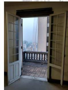
Figura 214 - Esquadria bastante danificada com ressecamento das madeiras e perdas de grandes áreas.
