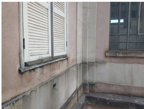
Figura 359 - Biofilme na pingadeira da janela, sujeidade na cimalha e biofilme na fachada.
