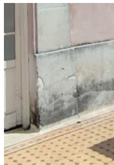
Figura 315 - Revestimento do barrado com biofilme e lacunas.
