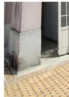
Figura 317 - Lacunas do revestimento da quina do requadro. Ponto de retenção de umidade por fissuração do barrado.
