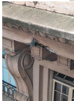
Figura 71 - Oxidação do buzinote com perda de área argamassa e biofilme nos ornatos.
