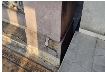
Figura 245 - Rachaduras na base do guarda-corpo e no piso, destacamento de argamassa.
