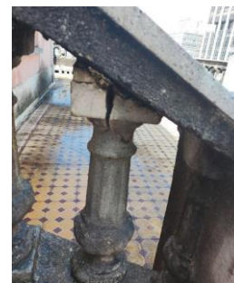
Figura 279 - Biofilme generalizado; risco estrutural no balaústre rachado.
