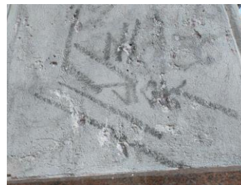
Figura 36 - Pichação na fachada no nível do térreo da Avenida São João.
