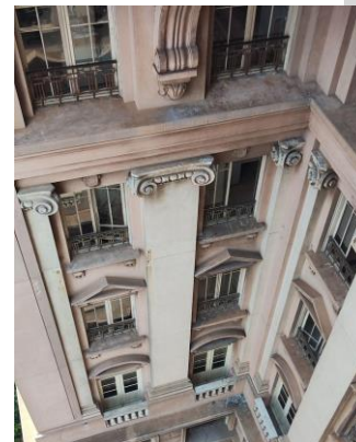
Figura 65 - Biofilme na moldura nas janelas e no peitoril; excremento de aves nos ornatos e peitoril.
