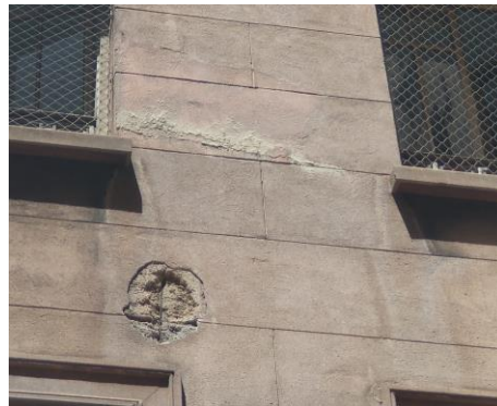
Figura 46 - Lacuna com exposição dos ferros da estrutura e presença de eflorescência de sais
