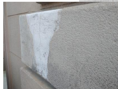
Figura 17 - Recomposição em material incompatível com a técnica.
