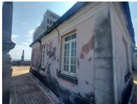
Figura 346 - Biofilme generalizado no barrado e cimalha; pontos esparsos nos panos lisos.
