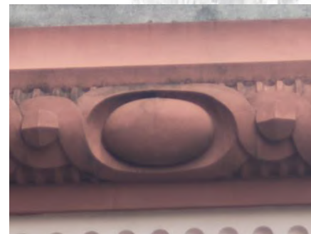
Figura 26 - Acúmulo de biofilme no ornato entre a mansarda e o guarda corpo do 26º pavimento.
