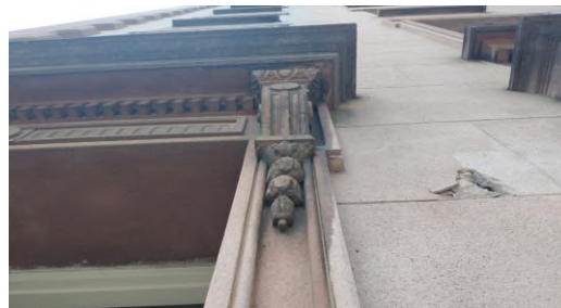
Figura 8 - Trecho da fachada com lacuna no revestimento e biofilme nos ornatos.
