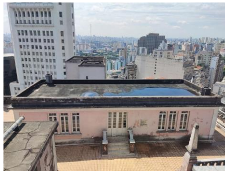
Figura 272 - Vista geral com acumulação de água e biofilme no terraço.
