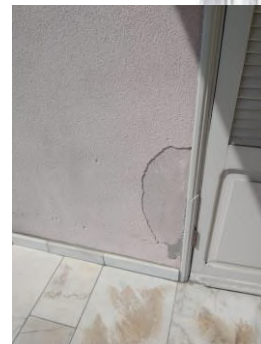
Figura 362 - Lacuna no revestimento da área coberta e biofilme no piso em mármore.
