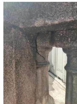
Figura 286 - Fissura no revestimento do balaústre.
