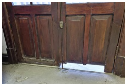
Figura 177 - Vista aproximada do trecho faltante e dos danos no trecho inferior da porta-janela.
