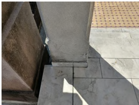
Figura 363 - Fissuras na parte inferior do pilar e biofilme na fachada.
