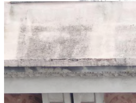
Figura 25 - Moldura da janela com biofilme e fissuras no revestimento.
