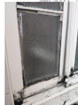
Figura 328 - Destacamento da massa de vidraceiro; falta e deterioração de elementos de madeira.
