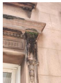
Figura 58 - Biofilme e infiltração.
