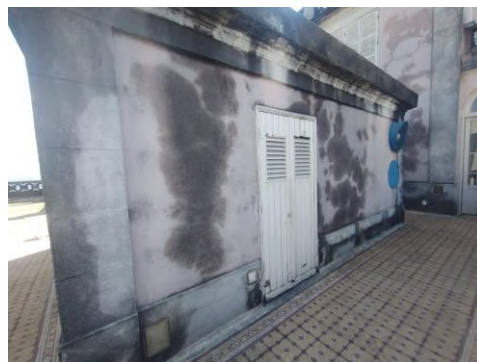
Figura 350 - Biofilme generalizado na cimbalha, barrado e quina; pontos de biofilme esparsos pelos painéis lisos; deterioração de madeira da esquadria.
