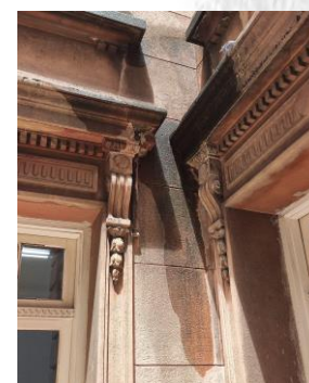
Figura 52 - Biofilme e umidade por infiltração.
