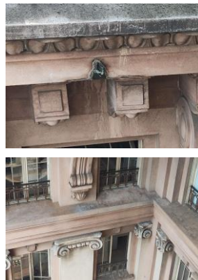
Figura 64 - Oxidação do buznote e sujeidade no peitoril da janela.
