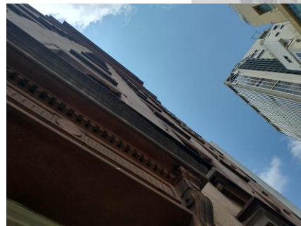
Figura 20 - Presença de biofilme na pingadeira da moldura da janela e nos ornatos.
