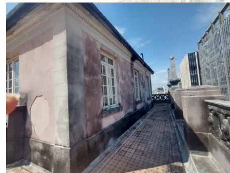
Figura 347 - Biofilme generalizado no barrado e cimalha; pontos esparsos nos panos lisos. Desprendimento de pintura pontual.
