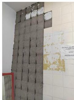
Figura 116 - Revestimento cerâmico em deslocamento.
