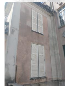
Figura 370 - Biofilme ao longo da fachada e infraestrutura sem sinalização.
