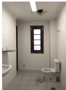
Figura 217 - Vista geral do Sanitário 27-14 com revestimentos cerâmicos contemporâneos nas paredes e piso. Lacuna e desprendimento de pintura no forro de gesso contemporâneo.
