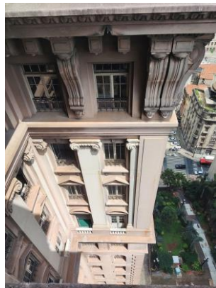
Figura 75 - Biofilme nos ornatos e oxidação do buzinode com perda de área argamassada.
