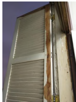
Figura 141 - Janela de madeira com desbaste da pintura de proteção.
