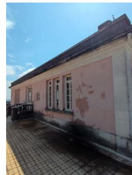
Figura 273 - Biofilme generalizado com deslocamento de pintura.
