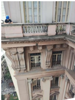
Figura 63 - Vista Geral mostrando concentração de biofilme no beiral, sujeidade no peitoril da janela e oxidação no buznote.
