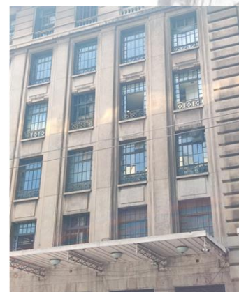
Figura 10 - Grafite vandálico no peitoril das janelas e no trecho inferior das colunas.
