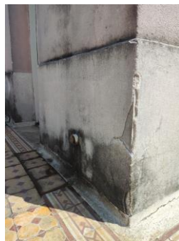
Figura 323 - Quina com lacunas do revestimento e biofilme no barrado; fissuração da granilite; ladrilhos fora do padrão.
