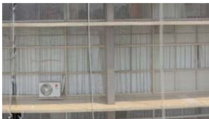
Presença de aparelhos de ar condicionado na Fachada Norte, 15º andar do Bloco D. FONTE: Drone Way/Instituto Pedra.
