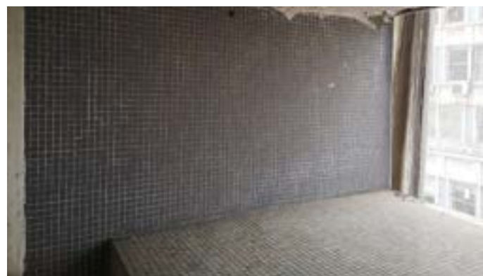
Situação da parte interna da empena Sudoeste, junto ao final dos brises da Fachada Norte. O pano revestido em pastilha cinza apresenta melhor estado de conservação do que os panos horizontais em pastilha branca. FONTE: Instituto Pedra.
