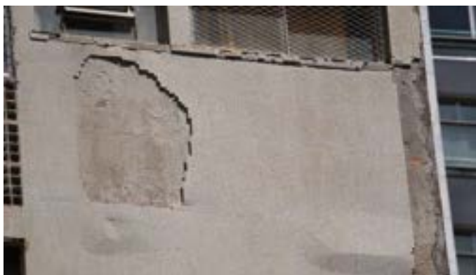
Lacunas de pastilhas nas escadas exteriores de serviço e empenas do Bloco A, na Fachada Sul, devido ao descolamento e deslocamento do revestimento. FONTE: Drone Way/Instituto Pedra.
