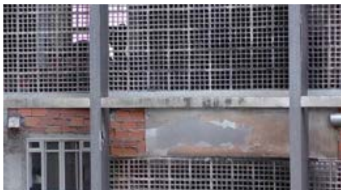
Presença de umidade e pátina biológica nas vigas da estrutura da Fachada Sul. FONTE: Drone Way/Instituto Pedra.
