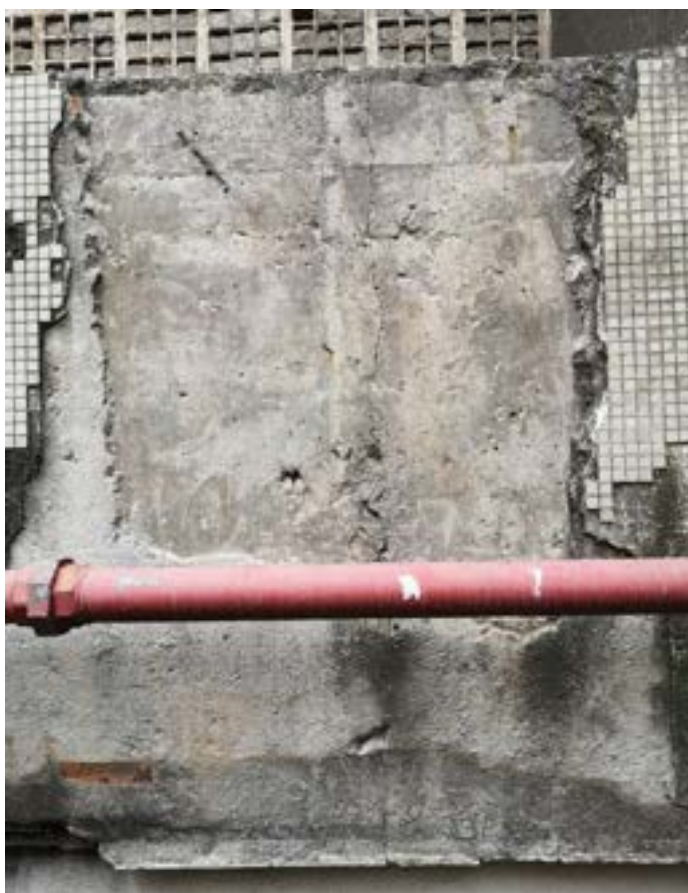
Fissura presente no concreto do elemento estrutural de transição do edifício. FONTE: Instituto Pedra.
