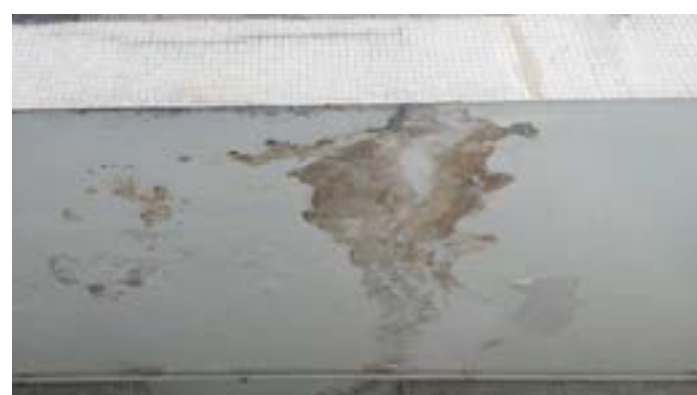
Sinais de umidade observados na marquise da cobertura do edifício. FONTE: Instituto Pedra.
