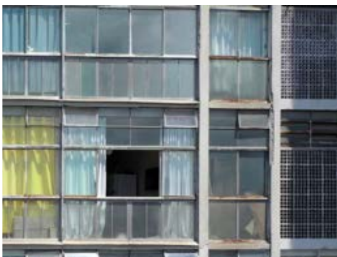
Caixilharia metálica oxidada na Fachada Sul, Blocos A e B. FONTE: Drone Way/Instituto Pedra.
