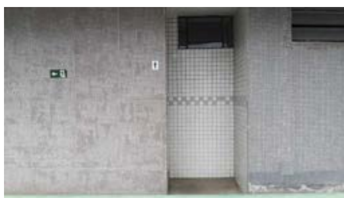
Intervenção com material diferenciado encontrada na cobertura do edifício. FONTE: Instituto Pedra.
