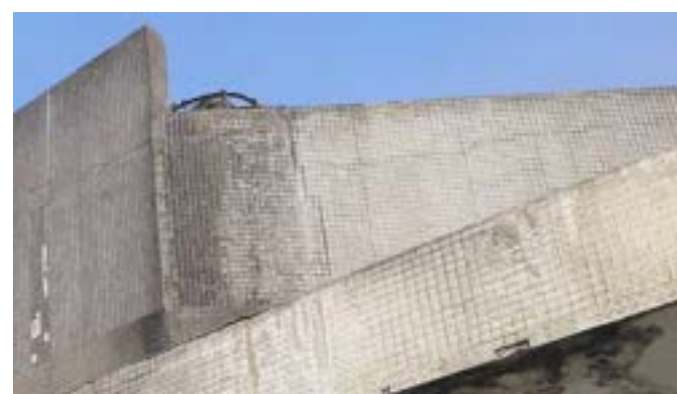
Fissuração e sinais de umidade presentes no revestimento de pastilhas da laje da cobertura do edifício. FONTE: Instituto Pedra.
