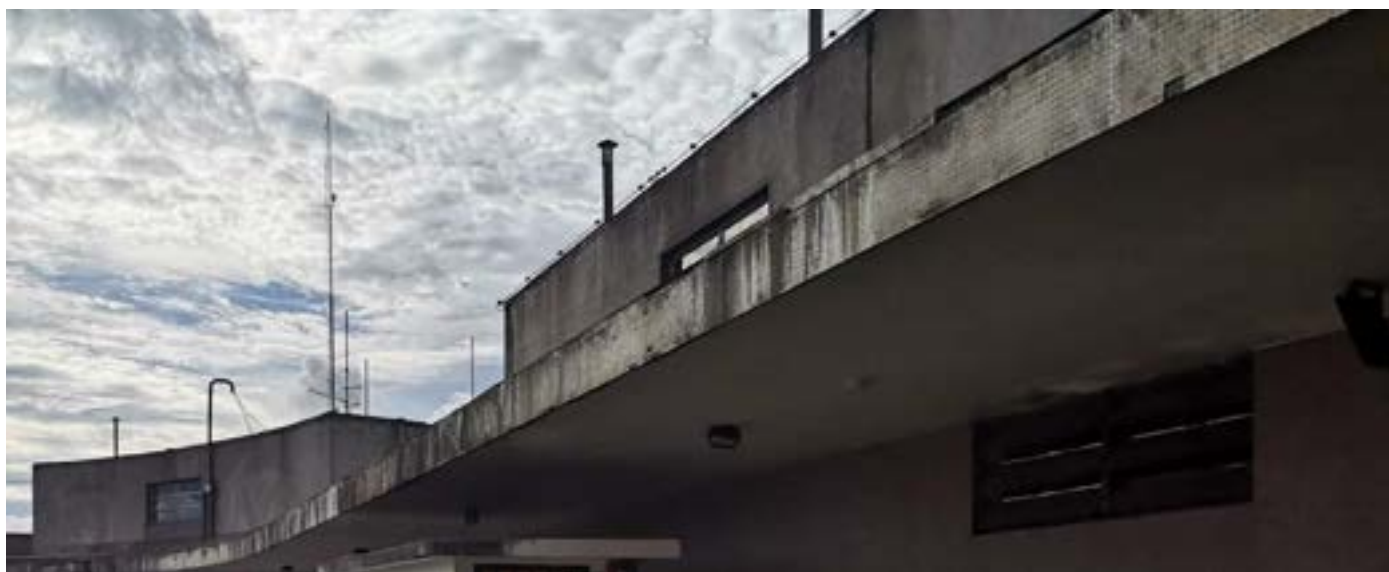
Sinais de umidade observados na marquise da cobertura do edifício. FONTE: Instituto Pedra.
