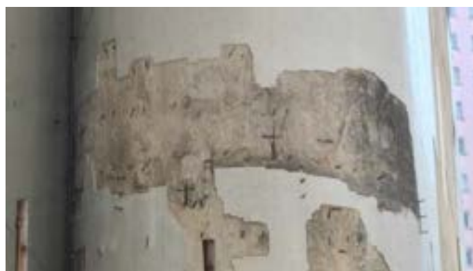
Presença de umidade, pátina biológica e armadura exposta, com sinais de oxidação, na torre de elevadores do Bloco B. FONTE: Instituto Pedra.
