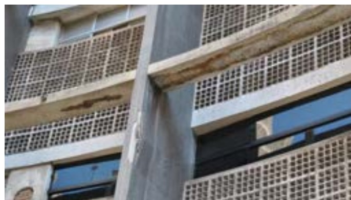
Revestimento com empolamento e deslocamento nos pilares exteriores do Bloco D, na Fachada Sul. FONTE: Instituto Pedra.
