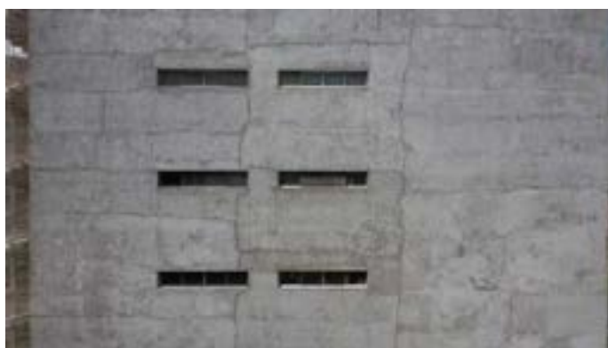
Fissuras visíveis no emboço executado na empena da Fachada Nordeste. FONTE: Drone Way/Instituto Pedra.
