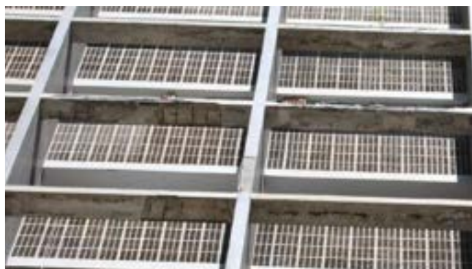
Armadura exposta nas vigas exteriores da Fachada Sul, com sinais de oxidação. FONTE: Instituto Pedra.
