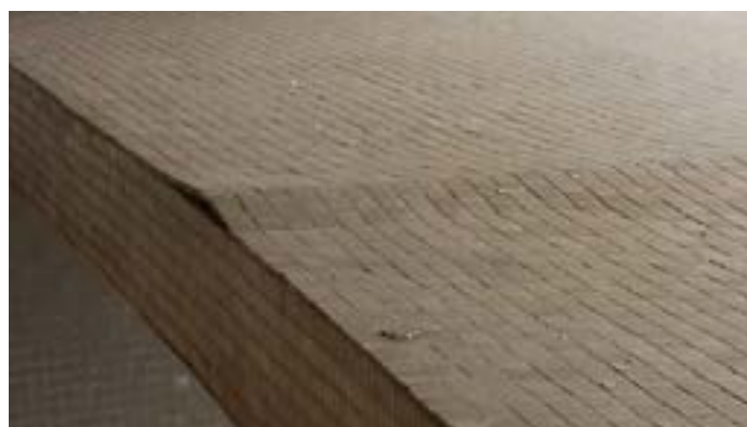
Descolamento do revestimento com empolamento, criando uma superfície irregular nos brises-soleil da Fachada Norte e facilitando o acúmulo de resíduos e entrada de água. FONTE: Instituto Pedra.
