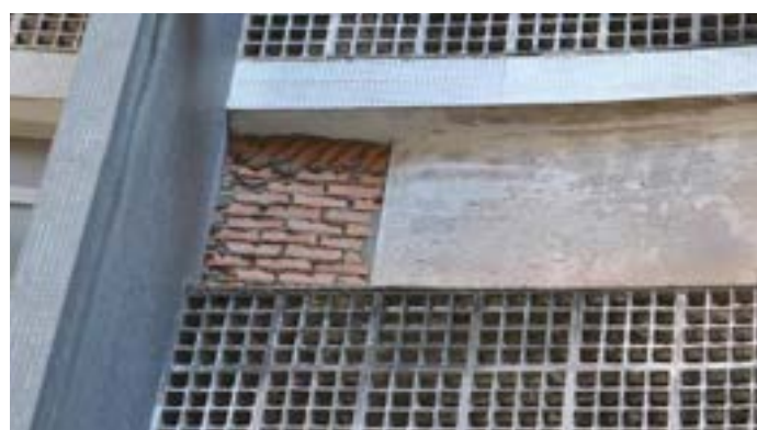
Vedação em tijolo discrepantes com os cobogós preexistentes na Fachada Sul. FONTE: Instituto Pedra.
