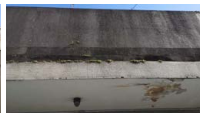
Presença de umidade e vegetação infestante na laje da cobertura do edifício. FONTE: Instituto Pedra.
