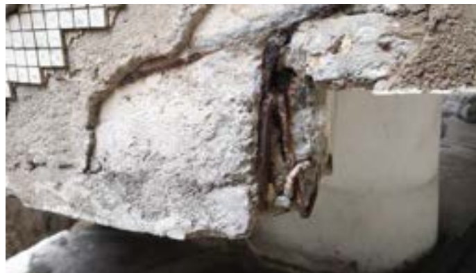
Concreto desagregado e armadura exposta com corrosão, na escada de serviço do Bloco F. FONTE: Instituto Pedra.
