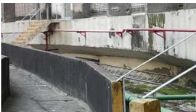
Presença de colonização biológica na base da Fachada Sul do edifício, devido à baixíssima exposição solar dessa zona, que intensifica as consequências da umidade. FONTE: Instituto Pedra.
