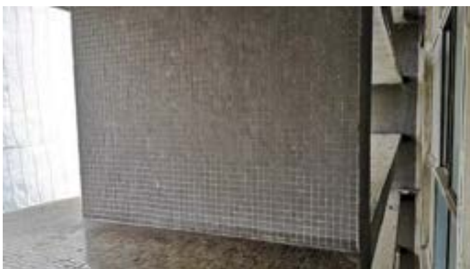
Situação de um dos pilares que estruturam os brises da Fachada Norte, aparentemente em melhor estado de conservação do que os elementos horizontais. FONTE: Instituto Pedra.
