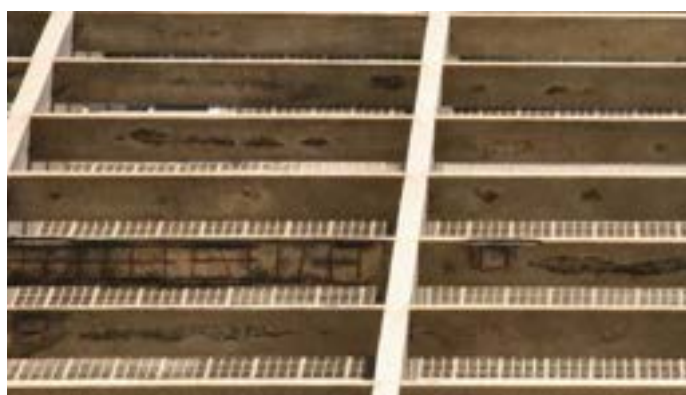
Concreto desagregado e armaduras expostas na Fachada Sul. FONTE: Instituto Pedra.
