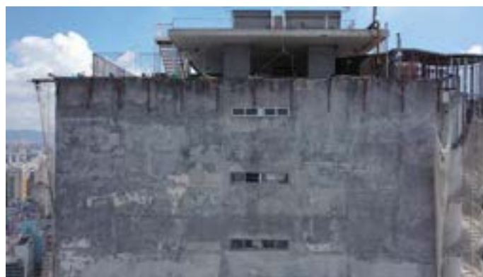
Sinais de umidade presentes no emboço executado na empena da Fachada Sudoeste. FONTE: Drone Way/Instituto Pedra.
