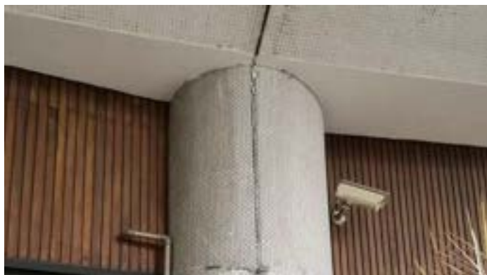
Pilares revestidos com pastilhas de dimensão diferente, em relação ao restante dos revestimentos do edifício. FONTE: Instituto Pedra.
