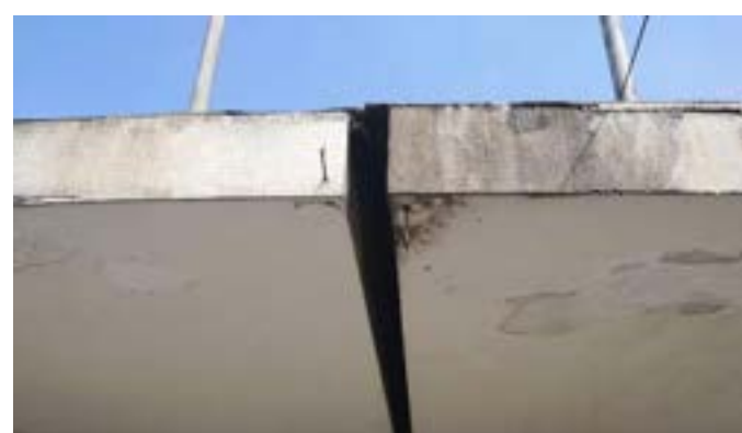
Presença de umidade e pátina biológica na laje da cobertura do edifício, próximo à junta de dilatação entre os corpos 3 e 4. FONTE: Instituto Pedra.
