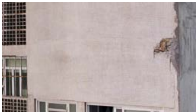
Concreto desagregado e ancoragem estrutural exposta na Fachada Sul, Bloco A. FONTE: Drone Way/Instituto Pedra.
