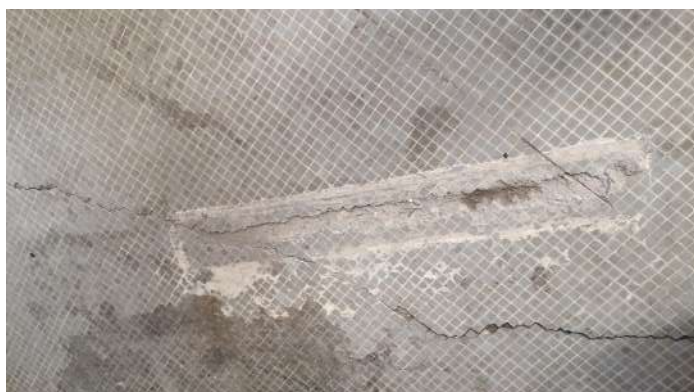
Fissuração no revestimento de pastilhas do piso da varanda, do pavimento "Foyer". FONTE: Instituto Pedra.
