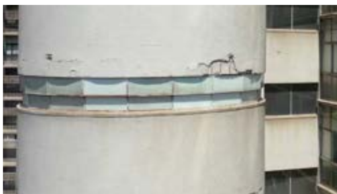
Lacunas de pastilhas e revestimento de argamassa e emboço na torre do Bloco B, na Fachada Sul, deixando parte da armadura estrutural exposta. FONTE: Drone Way/Instituto Pedra.
