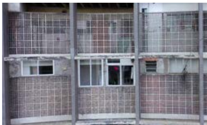
Substituição dos cobogós da Fachada Sul por caixilharia com vidro e vedações irregulares, no 15º andar do Bloco C. FONTE: Drone Way/Instituto Pedra.
