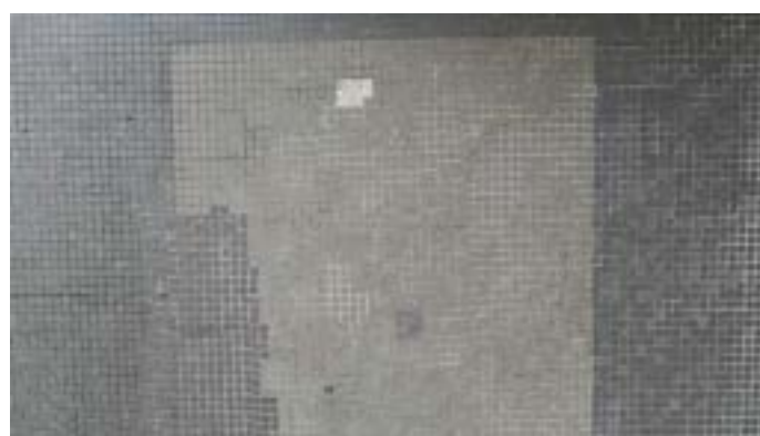
Material diferenciado encontrado na cobertura do edifício, próximo à junta de dilatação entre os corpos 1 e 2. FONTE: Instituto Pedra.
