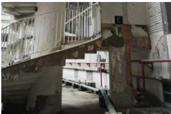
Lacunas de pastilhas e sinais de umidade nas escadas exteriores de serviço do Bloco E, na Fachada Sul, devido ao descolamento e deslocamento do revestimento. FONTE: Instituto Pedra.
