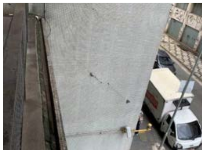
Fissuras localizadas na empena adjacente à Fachada Norte, que faz a divisa com o lote vizinho na Rua Araújo. FONTE: FAVALE.
