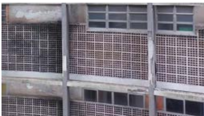
Fissuração do revestimento nas estruturas da Fachada Sul, com consequente descolamento e empolamento do revestimento. FONTE: Drone Way/Instituto Pedra.
