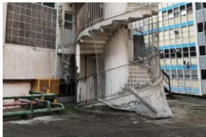
Situação atual da base da escada exterior de serviço do Bloco A, com os guarda-corpos com sinais de corrosão. FONTE: Instituto Pedra.
