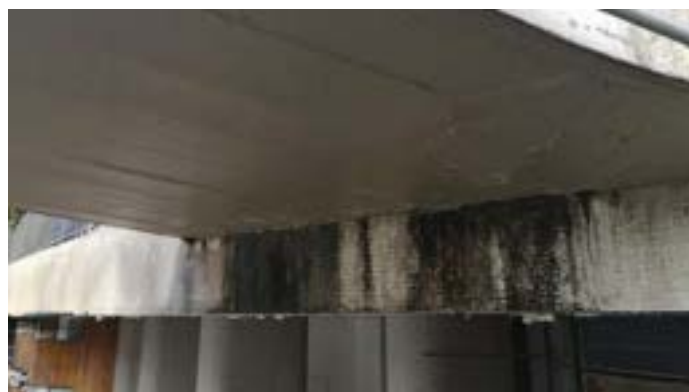
Presença de umidade e pátina biológica no encontro da laje do pavimento do Terraço com o patamar da escadaria exterior. FONTE: Instituto Pedra.
