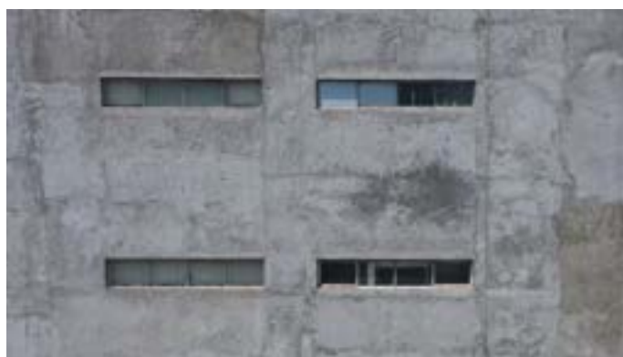
Sinais de umidade no emboço executado na empena da Fachada Nordeste. FONTE: Drone Way/Instituto Pedra.
