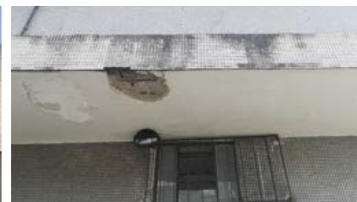
Presença de umidade, pátina biológica, destaque e desagregação do concreto, com exposição da armadura na laje da cobertura do edifício. FONTE: Instituto Pedra.
