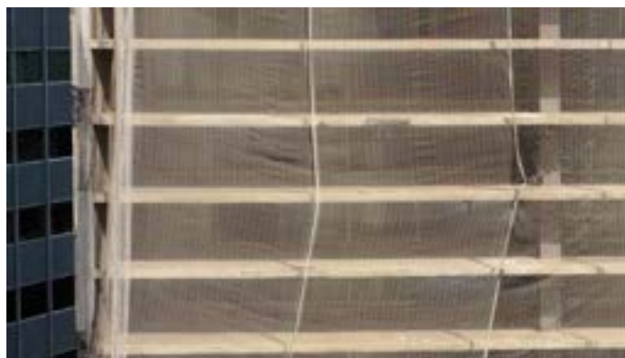
Sinais de desagregação de concreto e exposição de armaduras no Trecho 1 da Fachada Norte, junto à empena Nordeste. FONTE: Drone Way/Instituto Pedra.
