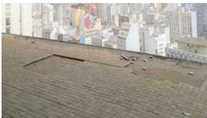
Lacunas de pastilhas nos brises-soleil da Fachada Norte, devido ao descolamento e deslocamento do revestimento.
