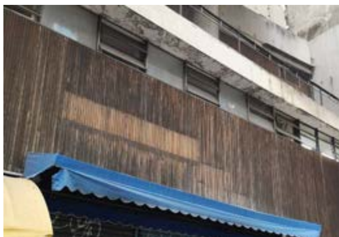
Alterações cromáticas presentes no revestimento de madeira do embasamento da Fachada Norte. FONTE: Instituto Pedra.
