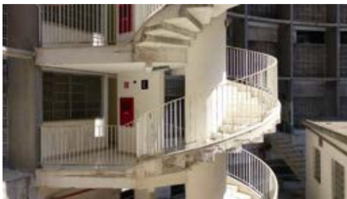
Lacunas de pastilhas nas escadas exteriores de serviço do Bloco E, na Fachada Sul, devido ao descolamento e deslocamento do revestimento. FONTE: Drone Way/Instituto Pedra.
