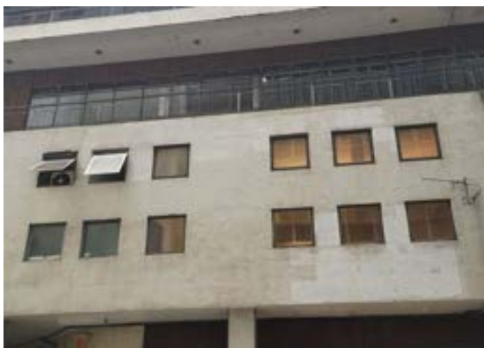
Presença de material diferenciado em trecho de pastilhas na Fachada voltada à Vila Normanda. FONTE: Instituto Pedra.
