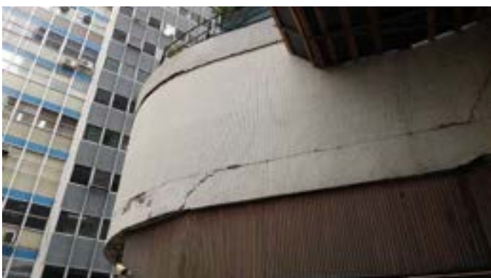
Fissuração no revestimento de pastilhas da fachada do pavimento “Terraço”. FONTE: Instituto Pedra.
