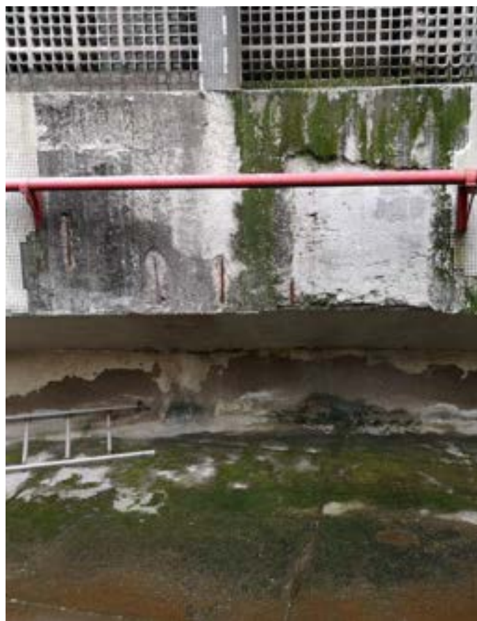
Armaduras expostas e colonização biológica avançada no elemento estrutural de transição do edifício. FONTE: Instituto Pedra.
