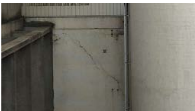
Fissuração visível no volume de circulação vertical do Bloco B, na Fachada Sul, devido à movimentação da estrutura adjacente. FONTE: Drone Way/Instituto Pedra.
