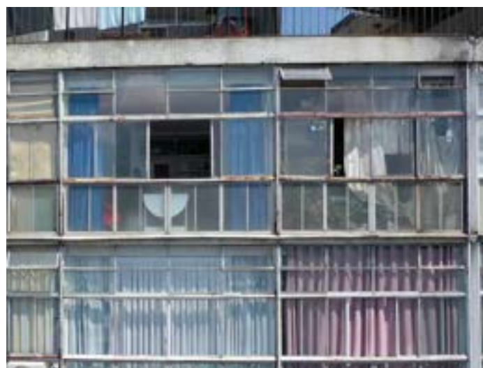
Caixilharia metálica oxidada na Fachada Sul, Bloco B. FONTE: Drone Way/Instituto Pedra.
