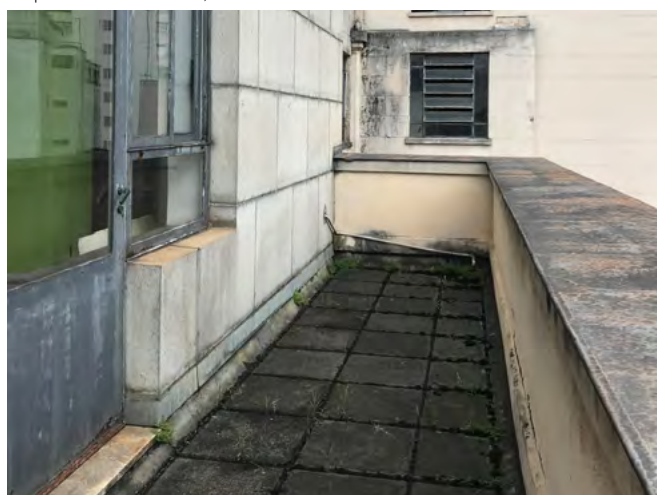
fig 45. Laje da varanda do 10º pavimento. Fonte: Acervo Ambiência Arquitetura e Restauro, 2022.
