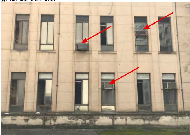
fig 62. Obtenção descaracterizadora de ar condicionado nos caixilhos.
