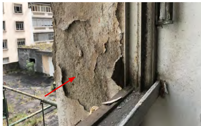
fig 67. Detalhe de trechos com eflorescência salina e esfoliação.
