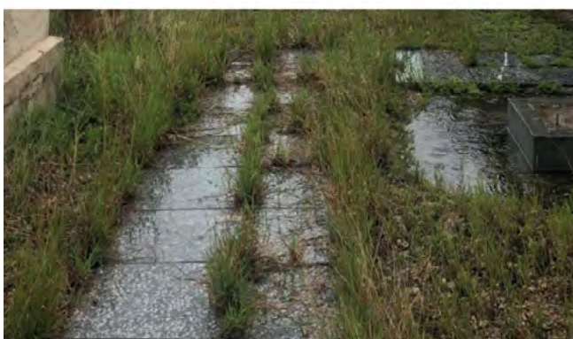
fig 221. Piso existente na cobertura, em placas soltas de granito. Fonte: Autoria Metro Arquitetos.
