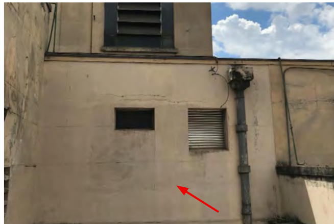
fig 61. Detalhe de trecho preenchido por obtenção errônea.
