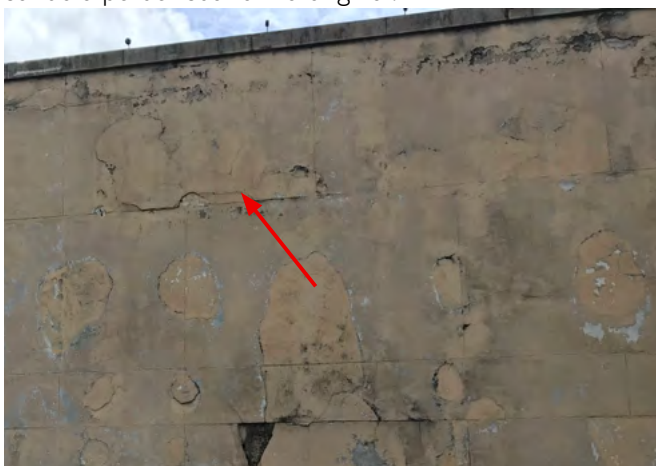
fig 64. Trecho de argamassa em processo de desprendimento.
