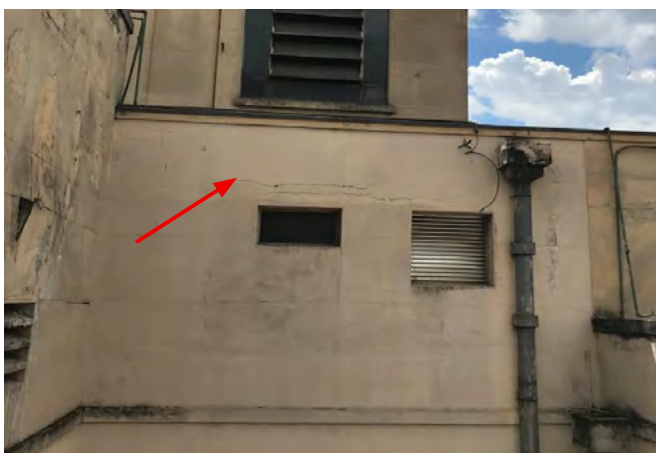
fig 74. Trincas e fissuras nas fachadas.
