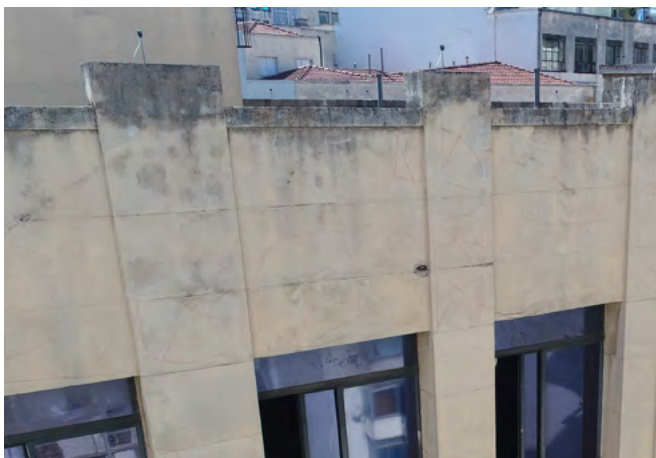
fig 70. Trechos com sinais de infiltração e umidade.
