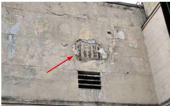
fig 66. Obtenção descaracterizadora com parte faltante da cimilha.
