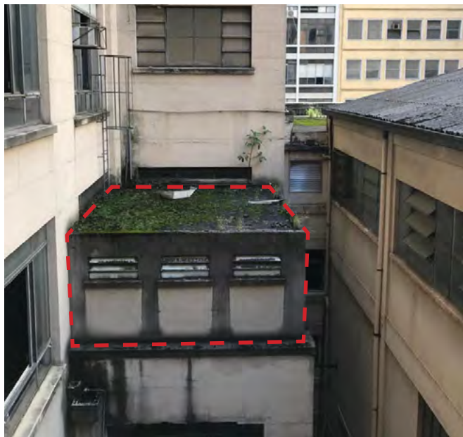
fig 120. Volume identificado como intervenções posteriores na fachada 3B Fonte: KRM Restaurações, 2022.
