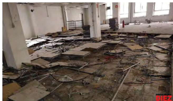
fig 154. Fotos internas dos elementos a serem removidos, já em processo de deterioração. Fonte: Diez Demolidora, 2022.
