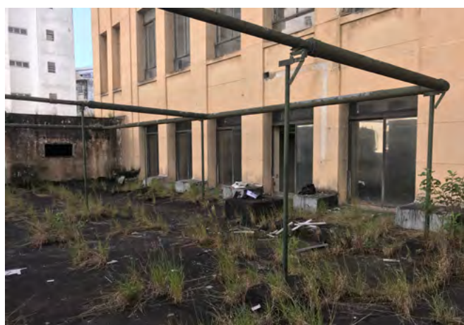
fig 44. Laje da varanda do 10º pavimento. Fonte: Acervo Ambiência Arquitetura e Restauro, 2022.
