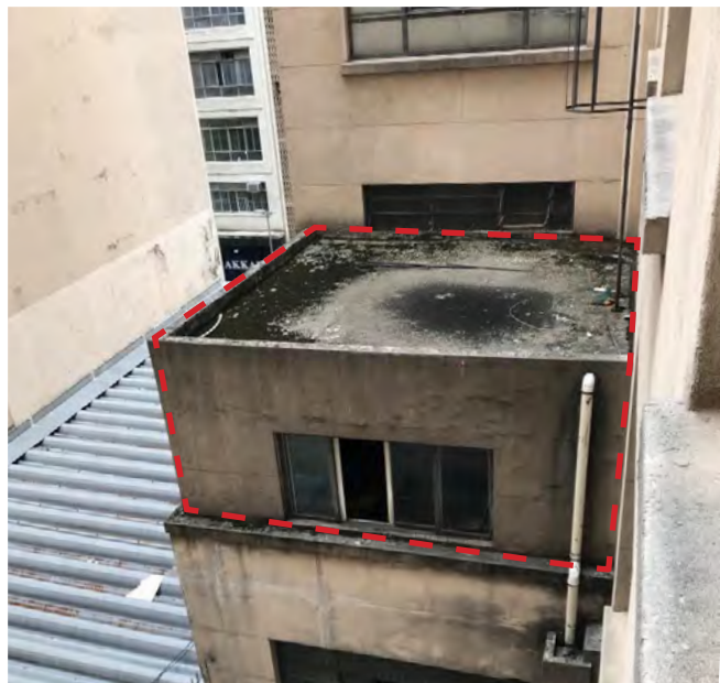
fig 125. Volume identificado como intervenções posteriores na fachada 4B. Fonte: KRM Restaurações, 2022.
