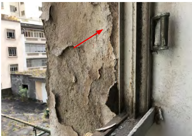
fig 68. Trecho com eflorescências salinas.
