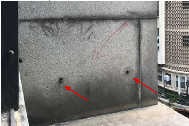
fig 60. Detalhe de elemento espúrio instalado sob a pedra.
