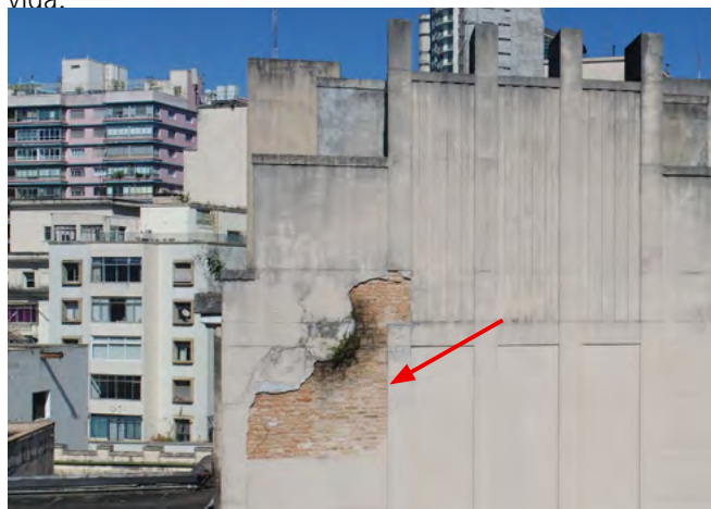
fig 63. Detalhe de trecho de argamassa faltante.
