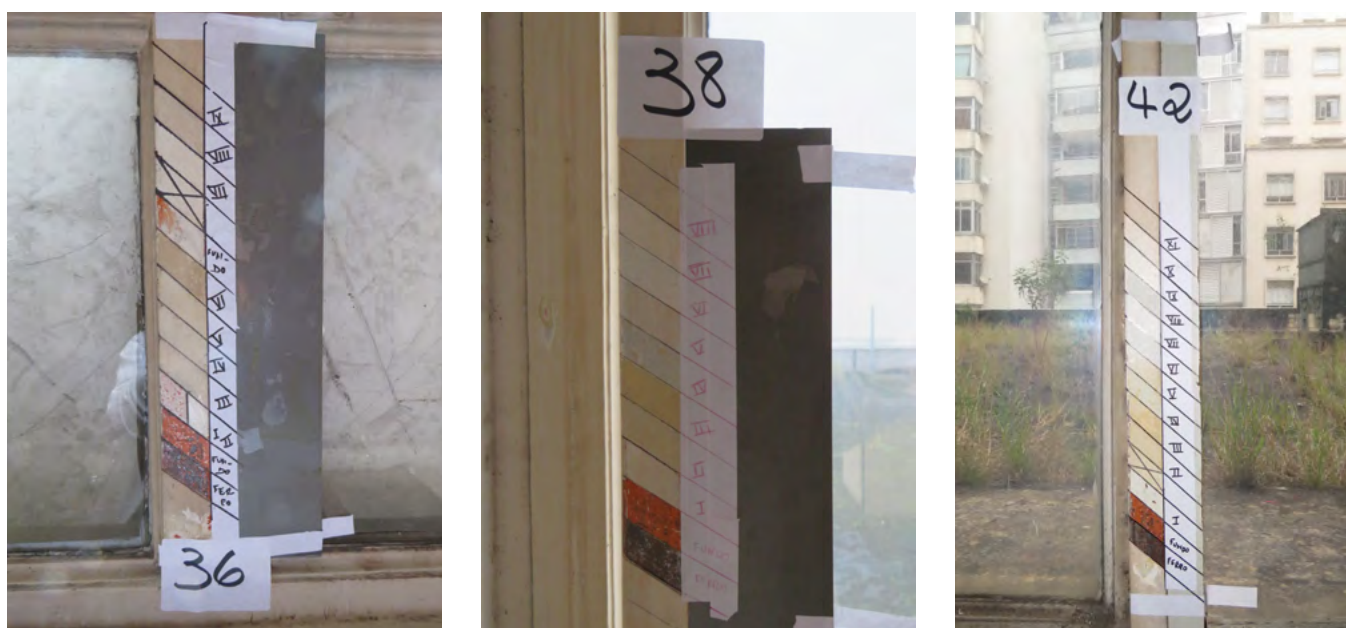
fig 143. Prospecções pictóricas das faces internas dos caixilhos. Fonte: KRM Restaurações, 2022.
